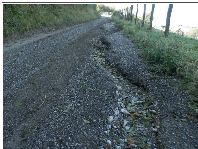
Figure n°17: Traces de ravinement sur le chemin du château de Quinsonnas
