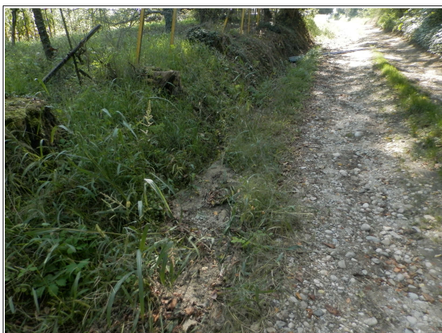
Figure n°16: fossé comblé par de la terre issue du ruissellement « Chemin du Devay »
